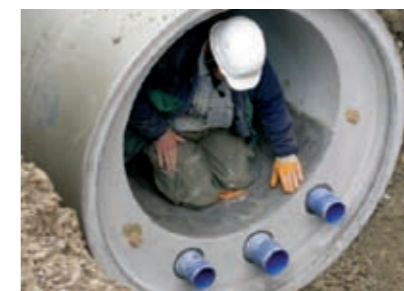
In dieser Kanalisationsröhre sind bereits drei Leitungen für die Wärmegewinnung eingebaut.
